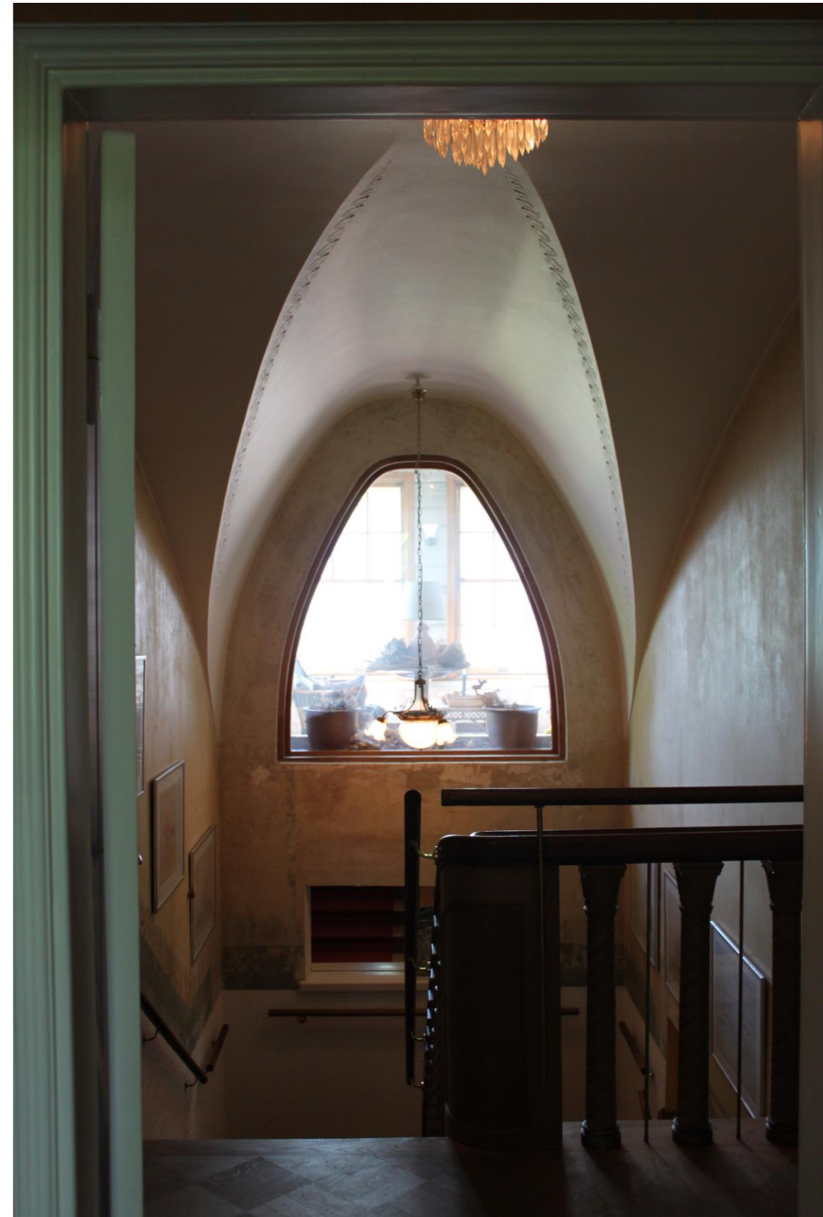
Kuva 21. Eteisestä toiseen kerrokseen johtava portaikko. Yläkerrasta on näkymä talvipuutarhaan. Portaan ikkunan kaarimuodot ja holvin koristeaiheet viittaavat jugend-vaiheeseen. Seinäpintojen rosainen maalaus on poistettu yläosaltaan. Alta paljastunut kelta-vihreä värirappaus on jätetty ennalleen.
