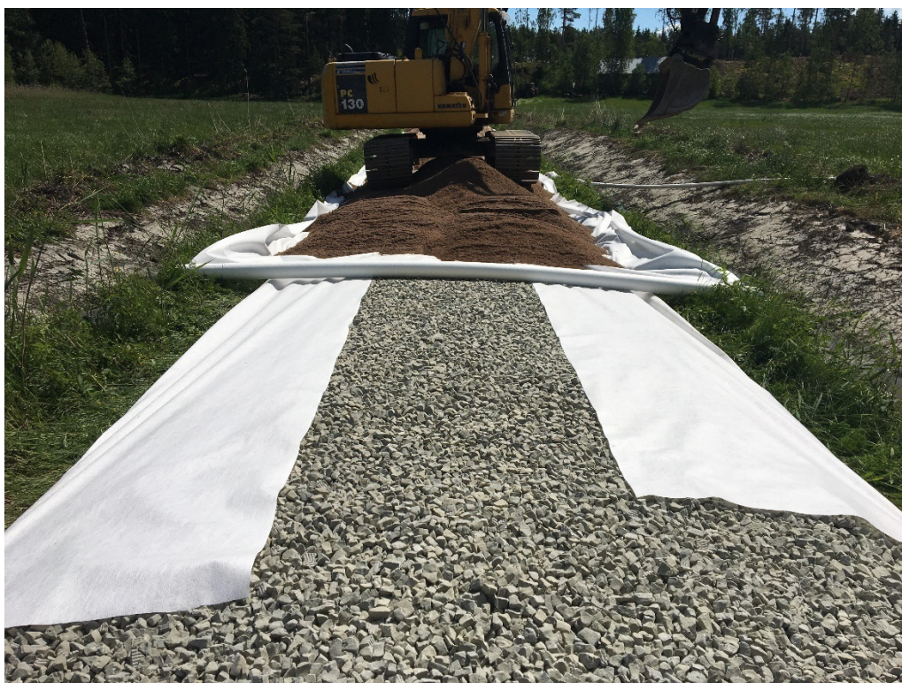
Kuva 2. Furunäs-Edön yksityistie kesä 2022; Rakenteen ja kuivatuksen parantaminen, tasausviivan korottaminen tulvakohteessa. Levitettiin n. 50 cm paksu kerros vaahtolasia ja laitettiin suodatinkankaan ”sisään”, päälle ajettiin soraa n. 20-30 cm. (kuva Kindstedt S.)
