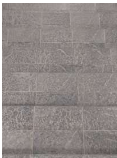
Kuva 7 Kauppakeskus Gallerian portaat ilman kontrastiraitoja
