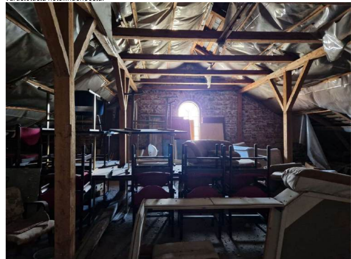
Kuva 48. Ullakon itäpäätä. Yläpohjaa on eristetty myöhemmin villoituksella ja sen alapuolelle on asennettu muovi. Reunoille on asennettu muovista kourut ilmeisesti kondenssivesiä varten.
