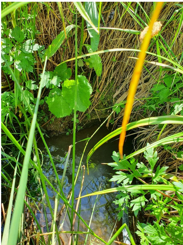
KUVA 5 Peltotien alittava betonirumpu on painunut ja ahdas
