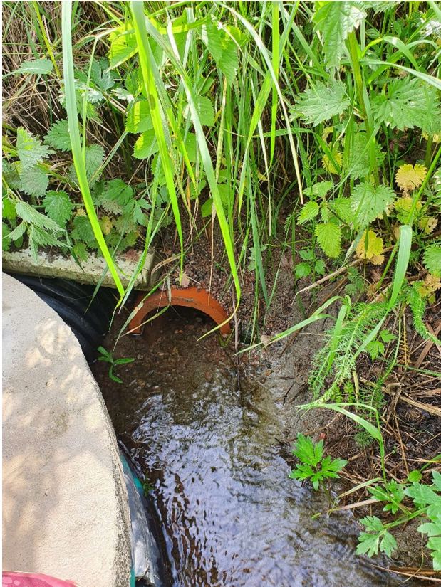
KUVA 7 Louhosalueen suunnasta tulevat vedet johtuvat eteenpäin alaojakaivosta/rummusta salaojakain vierestä (salaojien kokoojakaivo näkyy kuvassa vasemmalla)
