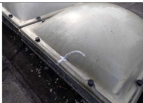
Kuva 28. Halkeama kattoikkunassa paikattu kittauksella.
