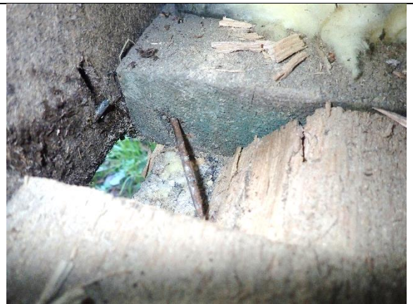
Kuva 18. Ulkoseinän alajuoksupuuh on osittain sokkelin ulkopuolella
