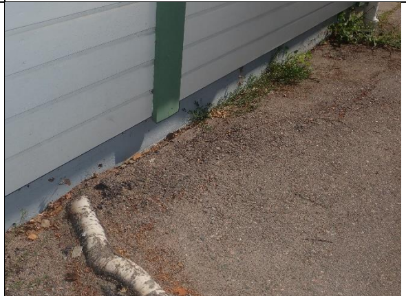
Kuva 42. Pihan puolella sokkelin alapuolelle menee useita puunjuuria ja sidontaputket maanpinnan tasolla
