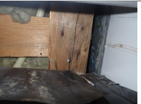
Kuva 20. Rakenneavaus yläpohjaan, ruodelaudoissa kosteusjälkiä
