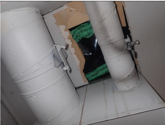
Kuva 19. Rakenneavaus yläpohjaan sosiaalitalassa, jossa valumajälkiä
