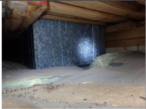
Kuva 36. Kuva vuotaneen tuuletuskanavan kohdalta yläpohjassa, vuotojälkiä imulaatikon ulkopinnalla
