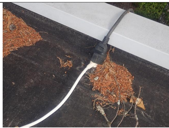
Kuva 22. Sulanapitokaapeli ei ole sähköasennusten mukainen
