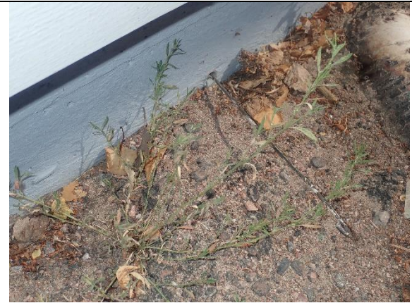
Kuva 40. Sokkelin valumuotin sidontaputkien reiät ovat avoimia, osa reiästä on maanpinnan tasossa/alla
