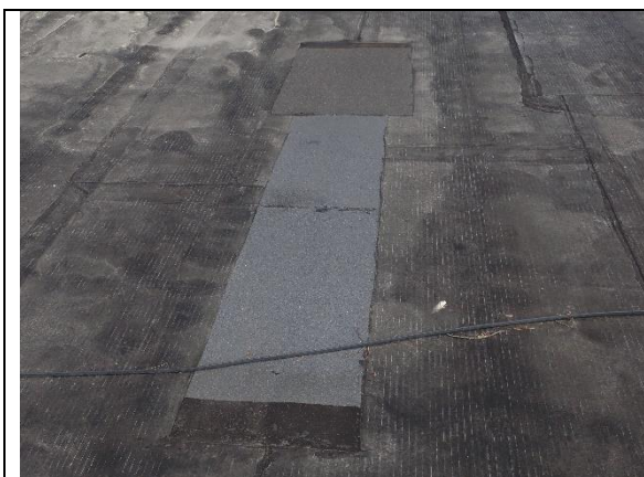
Kuva 23. Paikattu kohta katossa
