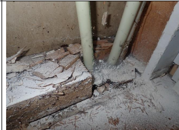
Kuva 14. Lähikuva rakenneavauksesta, seinässä ei eristettä, seinän sisällä rakennusjätettä/pölyä ja levypinnoilla vesivaluma jälkiä.
