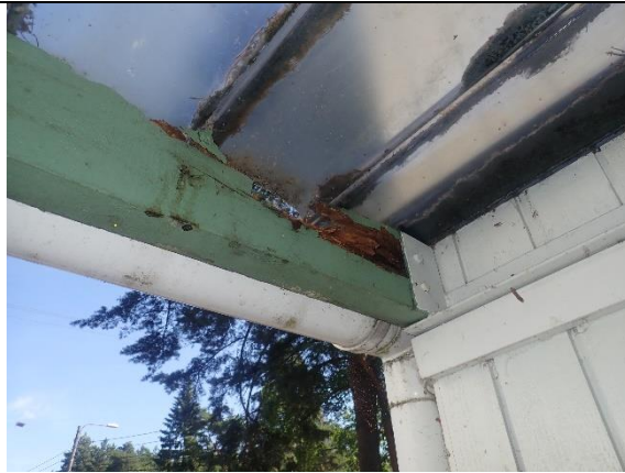
Kuva 39. Lahovaurioitunut valokatteen kannatinpalkki, keittiön oven katos.
