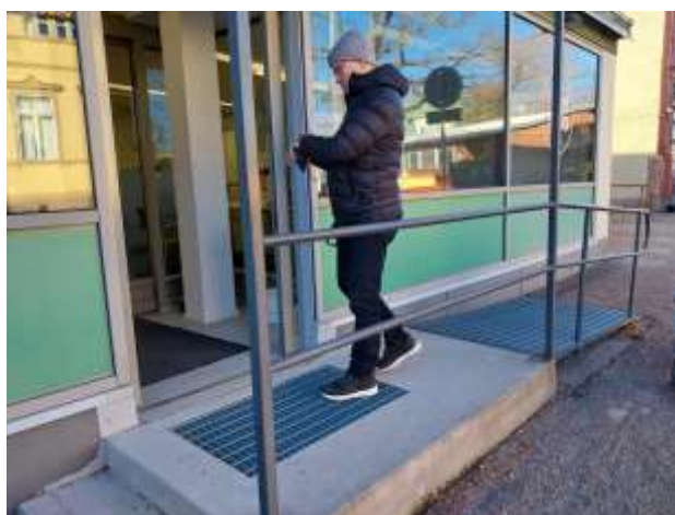
Bild 18 LovInfos automattörr och trapporna utan ledstång
