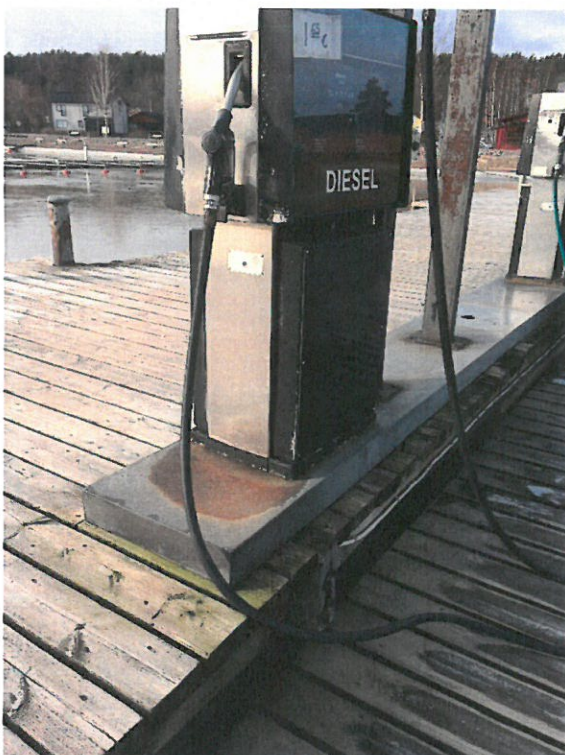
Bensinpumparna är gamla och borde bytas ut.
