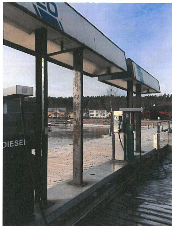
Skyddsbasäng för spill saknas.
