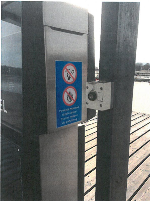
Nödstopknappen, skyltning saknas.
