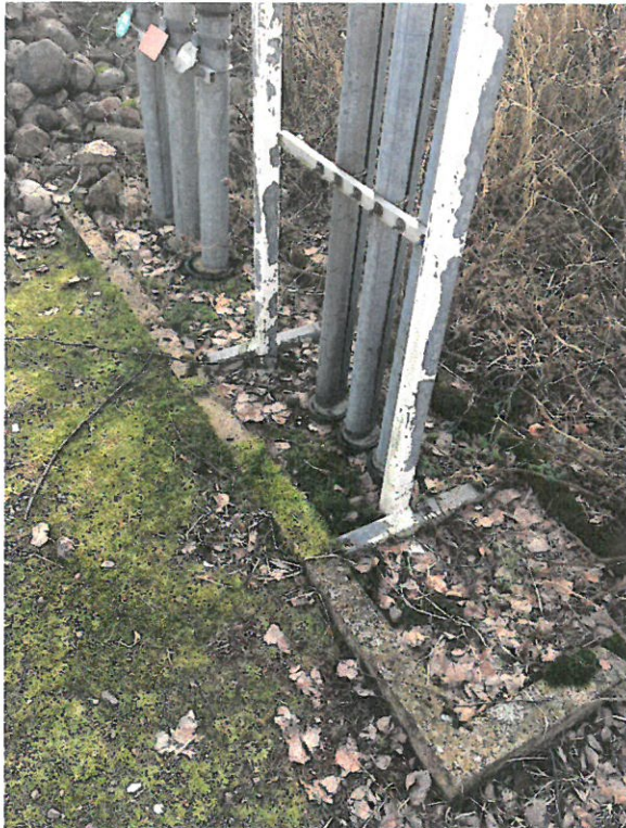
Påfyllningsplatsen, saknar skydd för markspill.
