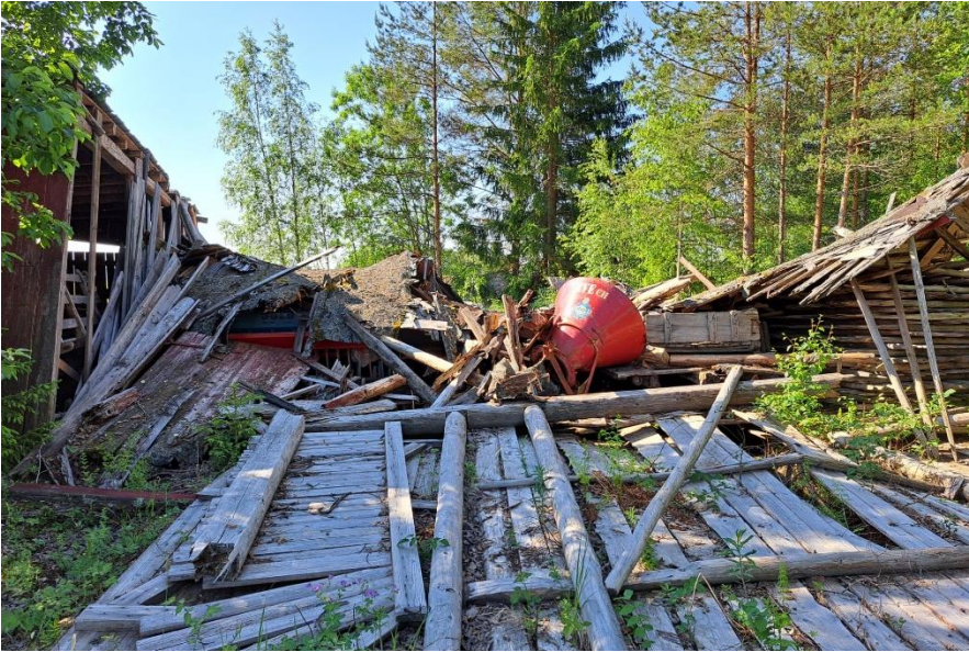
Kuva 7. Alueen pohjoisosassa oli myös romahtanut varastorakennus
